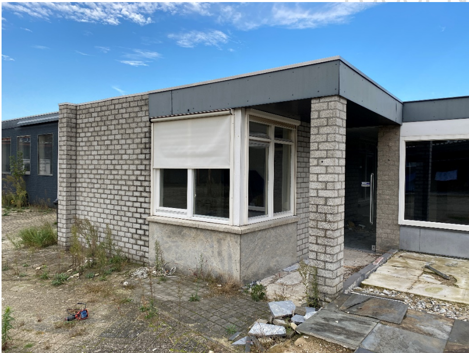
Figuur 6. In het bijgebouw zijn een aantal open stootvoegen te vinden die toegang bieden tot de spouw.
