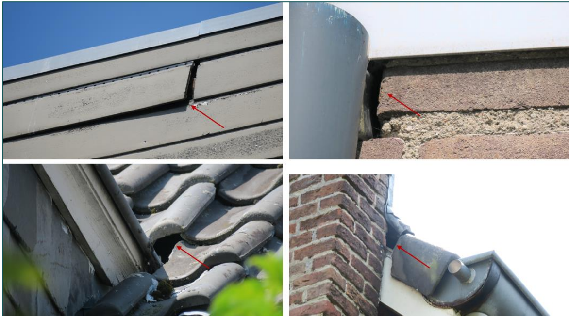
Figuur 3.1 De bebouwing bevat een verscheidenheid aan openingen welke vleermuizen toegang bieden tot de spouwruimte en/of dakruimte.
