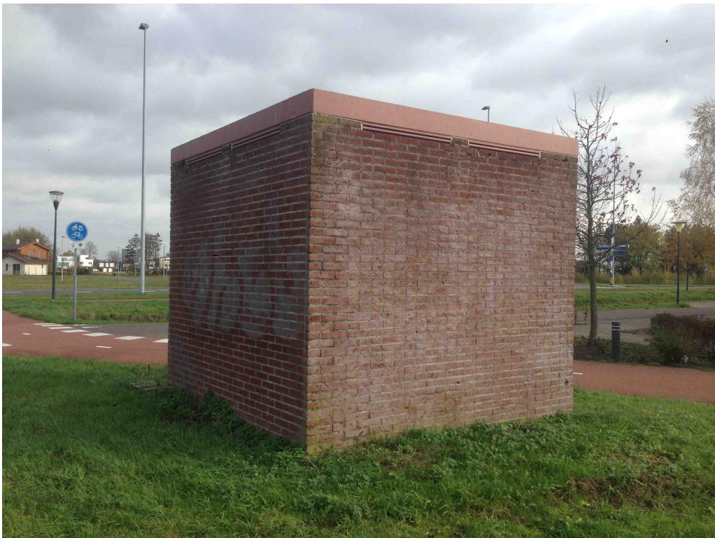
Figuur 4 Op de planlocatie zijn twee trafostations aanwezig. Bovenstaand station blijft gehandhaafd. Het station in het deelgebied fase 2 wordt, indien mogelijk, verplaatst.
