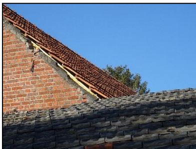
Figuur 7. Door het aanbrengen van isolatie is er in de aangrenzende schuur ruimte tussen de dakpannen en het nieuwe dakbeschoot aanwezig.
