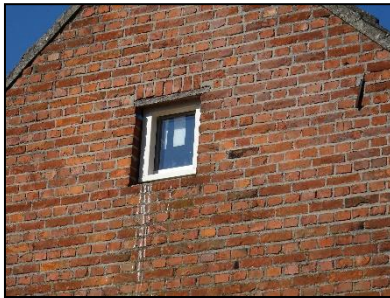
Figuur 18. Nieuw raam in aangrenzende schuur, roestplek niet meer bereikbaar.
