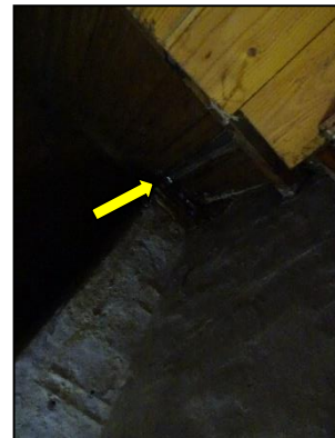
Figuur 3. Opening naar buiten bij houten zolderdak en schoorsteen.
