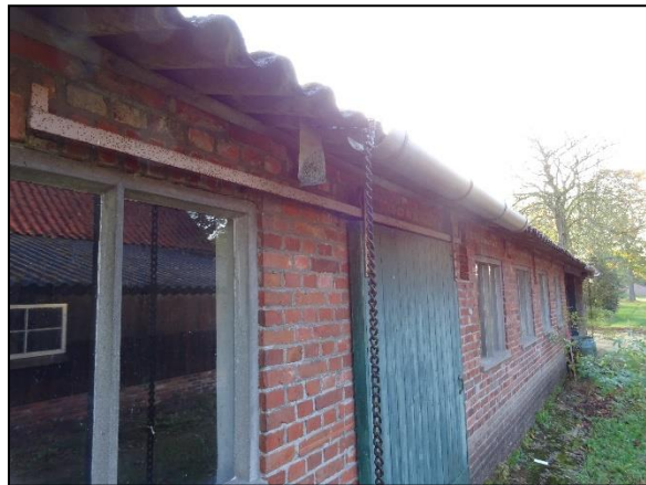
Figuur 11. Dakgoten onder golfplaten dak schuur.
