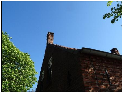
Figuur 4. Zelfde openingen onder de dakpannen nog aanwezig tijdens tweede veldbezoek.
