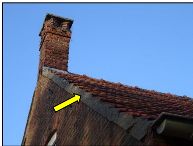
Figuur 1. Openingen tussen dakpannen eerste veldbezoek.
