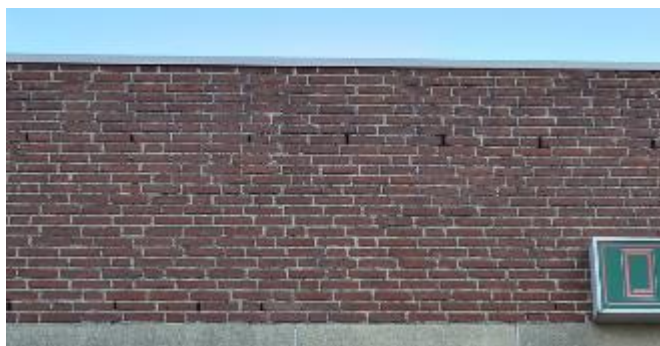
Figuur 4: Open stootvoegen in de westgevel
