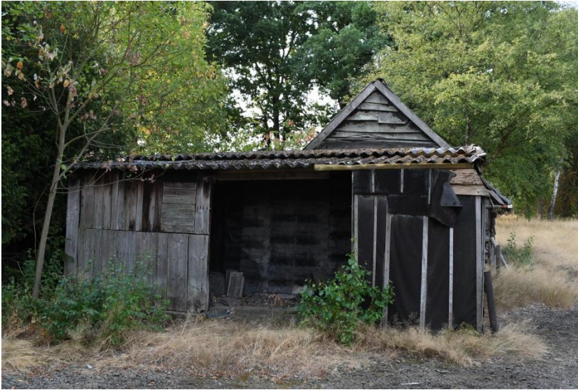
Foto 12: deelgebied 4 – aanbouw achter schaapsstal (met golfplaten dak en bitumen gevelbekleding) gezien vanuit noord- in zuidelijke richting
