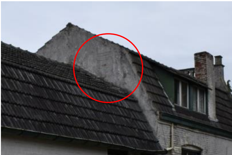
Achteregevel noordelijk gedeelte van de molenwoning met dichtgemetselde raamopening (rood omcirkeld).
