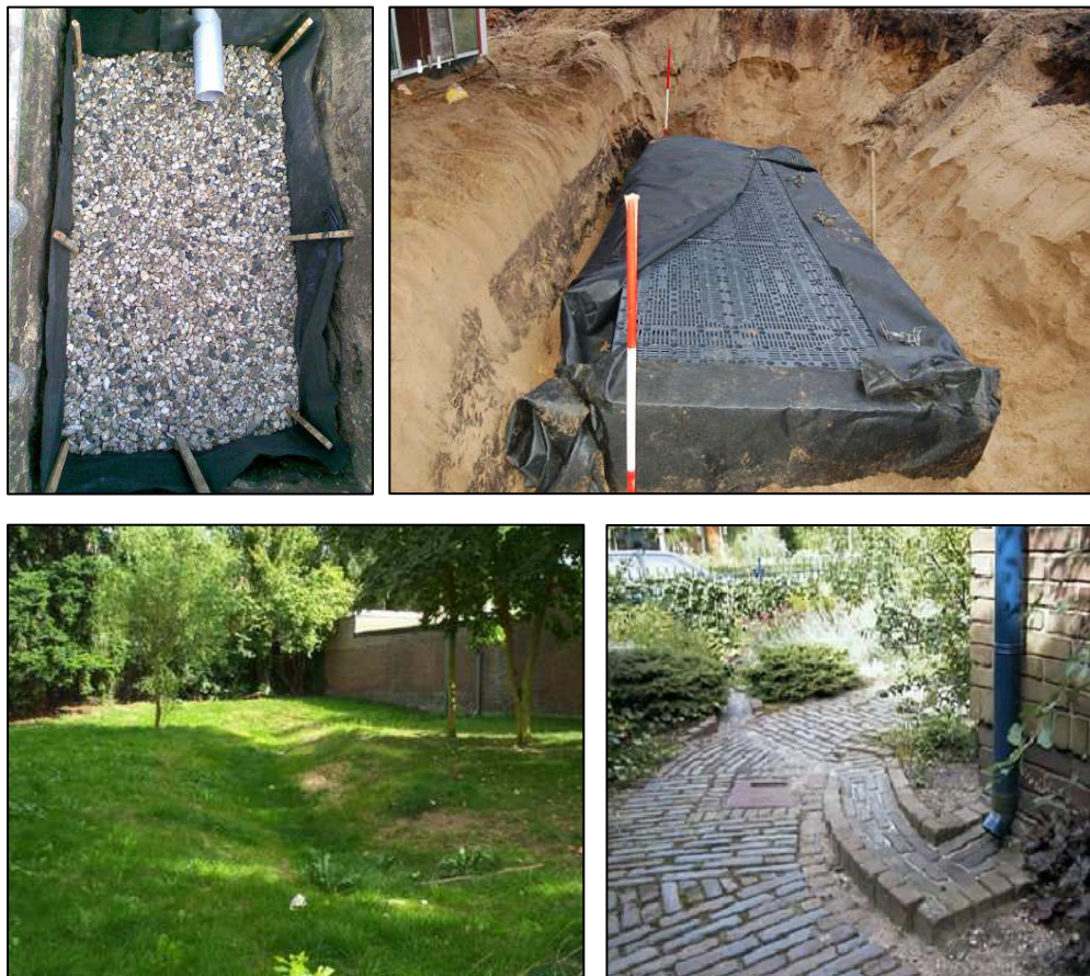
Figuur 17: Voorbeelden infiltratievoorzieningen
