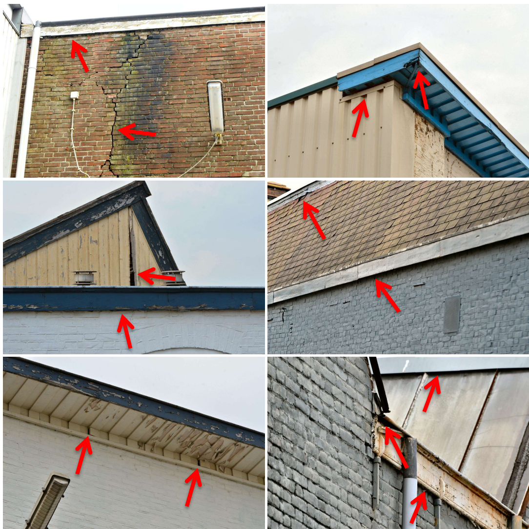
Figuur 6. Kieren, scheuren en gaten bieden toegang tot mogelijke verblijfplaatsen voor vleermuizen.
