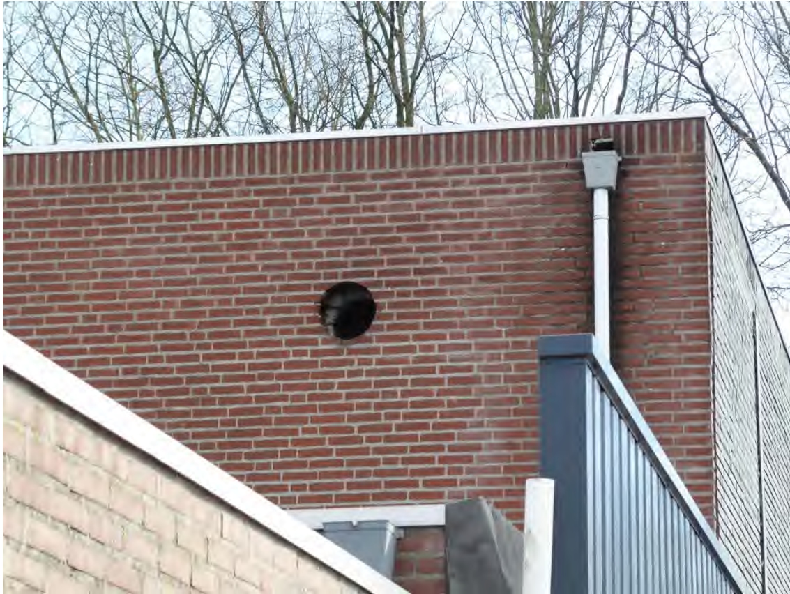
Afbeelding 4 Opening in de muur van de loods.
