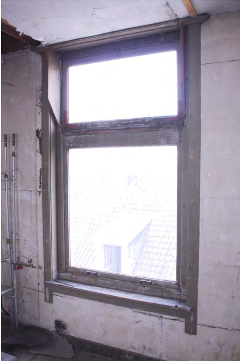
Het rechter venster met ongedeeld schuifraam en later aangebracht kiepraam op de bovenste verdieping. De kozijnstijlen lopen aan de onderzijde een stuk door.
