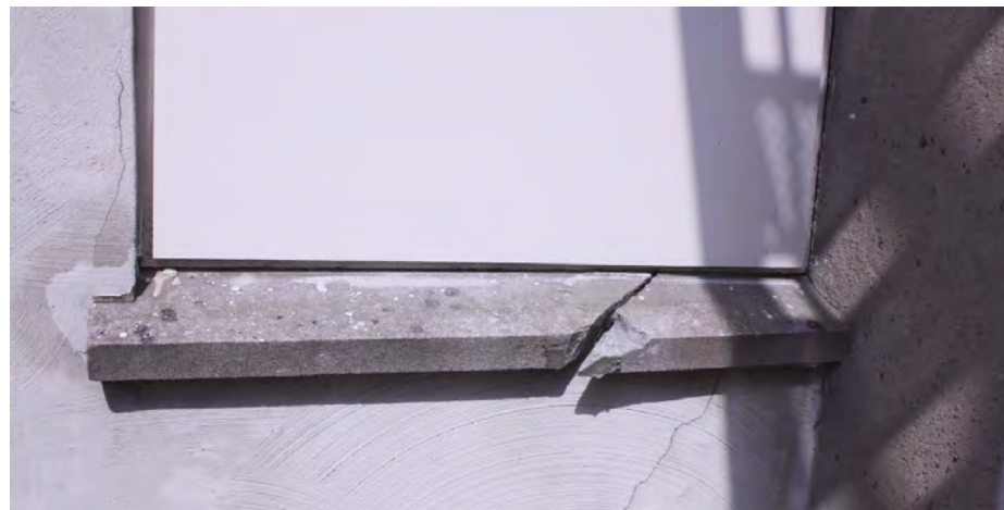
Het venster, links van de centrale schoorsteen op de eerste verdieping, is minder hoog dan de andere vensters. De oorspronkelijke onderdorpel verkeert in een slechte staat.
