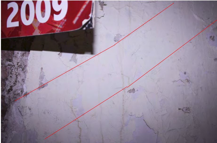
Ter hoogte van de trapopgang is nog een afdruk zichtbaar in het pleisterwerk van een trapboom van de voormalige trapopgang.
