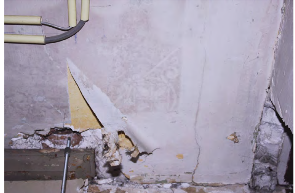
Het stucplafond boven de linker ruimte tegen de achtergevel is voorzien van een behang met gesjabloneerde hoekornamenten.
