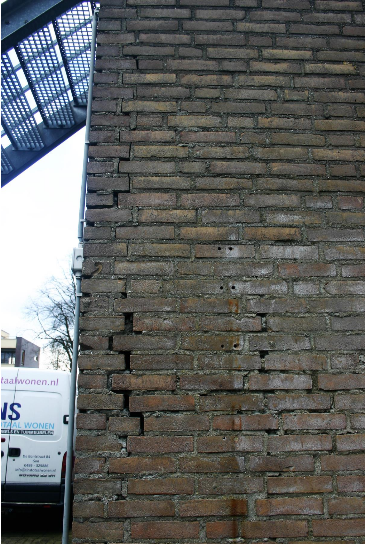
Figuur 20. Kieren in de stenen muur aan de achterzijde van de meubelwinkel.
