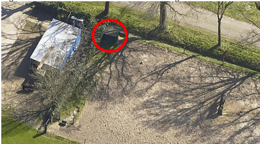
Figuur 2.2: asbestverdachte dakbedekking
