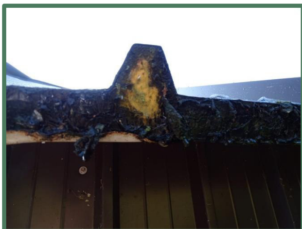
Gebrek aan ruimte tussen de sandwichpanelen
