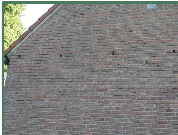
Open stootvoegen in de zuidelijke wand
