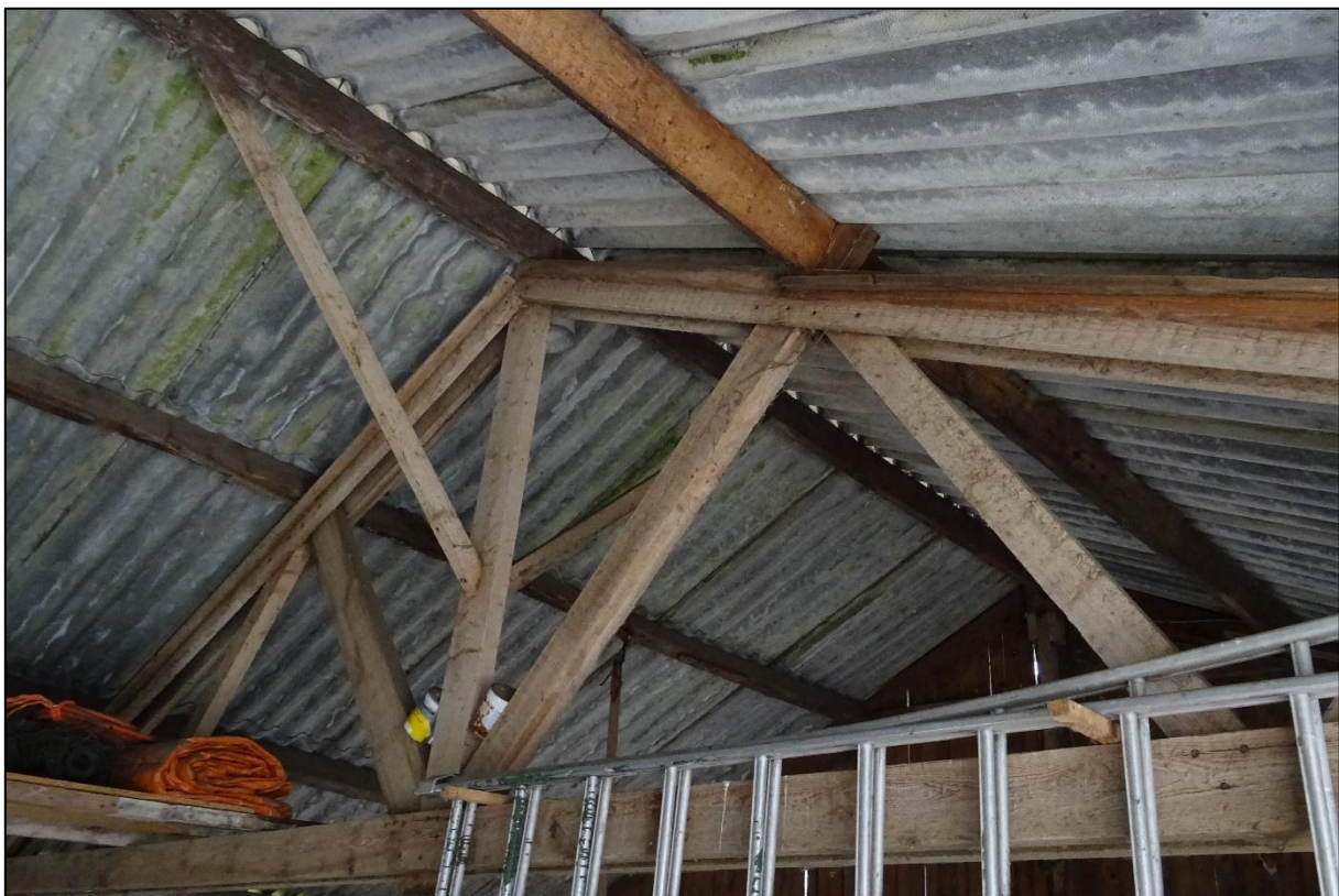
Afbeelding 13. Binnenaanzicht dak kleinste bijgebouw, ook dit dak is niet geïsoleerd waardoor tocht onder de dakplaten optreedt
