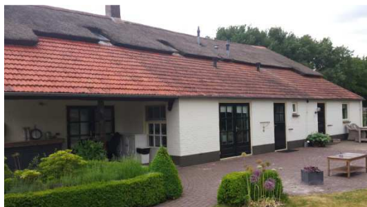
Foto links: uitgebouwde achtergevel, waarbij het dak uitgevlakt is. Foto rechts: bloktand in oorspronkelijk metselwerk onder de dakvoet.
