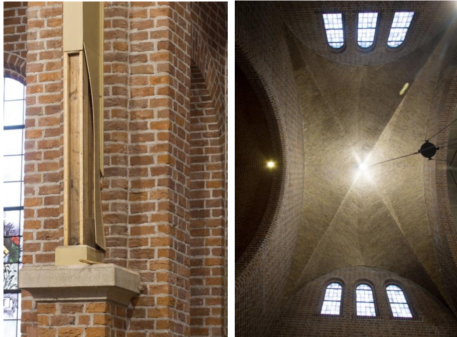
Afbeelding: Detail van één van de kniespanten. Het hout van de spanten is van meet af aan afgetimmerd.
