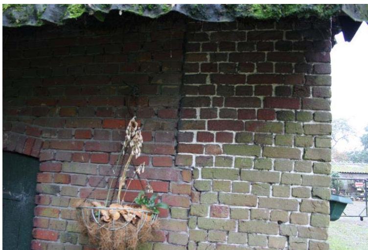
Hoek voorgevel/rechterzijgevel met naad in het metselwerk
