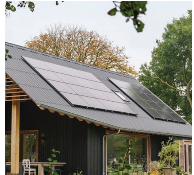
Zonnepanelen verwerkt in het dakvlak
