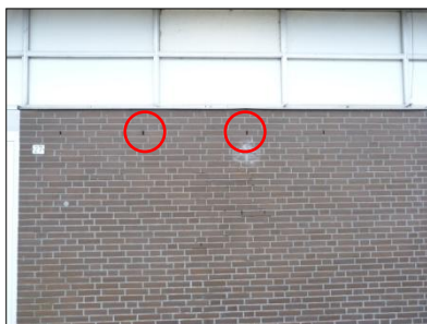
Figuur 10. Open stootvoegen aan de muurzijde van de Kanariestraat.
