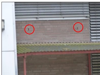
Figuur 11. Open stootvoegen aan de achterzijde van de bebouwing.
