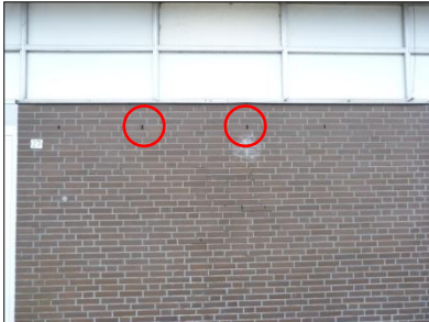
Figuur 11. Open stootvoegen aan de muurzijde van de Kanariestraat.
