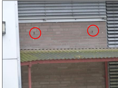
Figuur 12. Open stootvoegen aan de achterzijde van de bebouwing.
