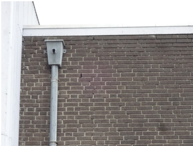
open stootvoeg in blinde spouwmuur
