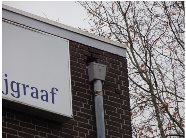
gat in spouwmuur boven hemelwaterafvoer
