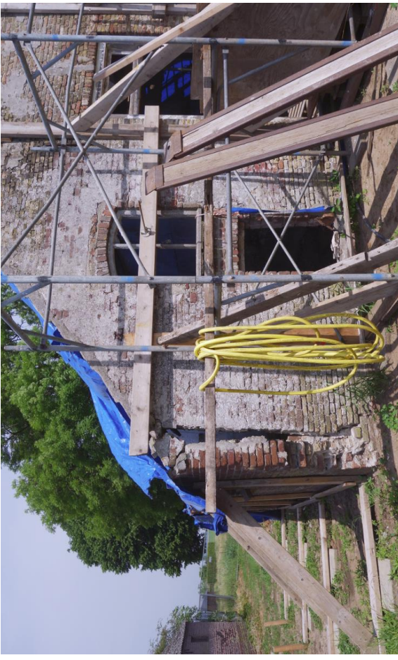
De aansluiting van de zuidgevel met de westgevel is los gescheurd.
