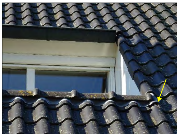
Figuur 14. Overhangende en kapotte dakpannen van woonhuis geschikt als nestlocatie huismus.
