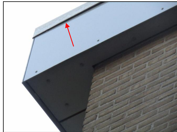
Figuur 15. Ruimte achter de dakbescherming biedt mogelijk verblijfplaatsen voor vleermuizen.
