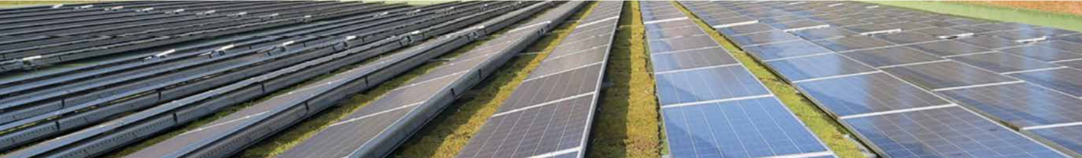
De ruimte op het dak maximaal benutten voor energie opwekking.
