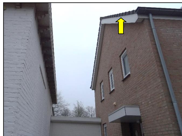
Figuur 17. Overhangende dakpannen bij de woning grenzend aan de onderzoekslocatie.
