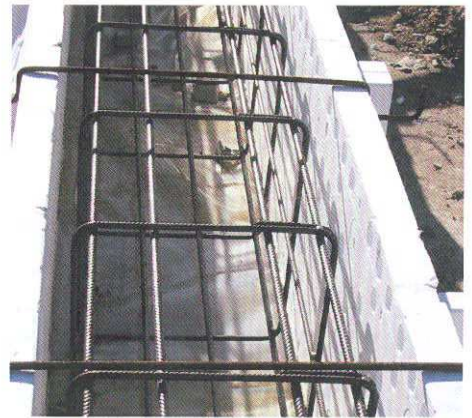
Bekisting en wapening in de funderingsbalk. De PS bekisting dient tegelijkertijd als trillingisolator.
