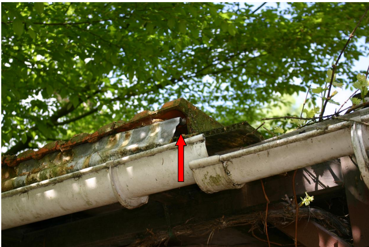
Figuur 9. De ruimte tussen de dakgoot en dakpannen is deels dichtgemaakt met lood (links op de foto), maar een kleine opening blijft zichtbaar (rode pijl). Het overige deel van de dakgoot hangt in de open lucht (geen ruimte voor huismussen; rechts op de foto).
