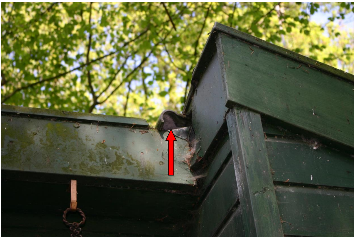
Figuur 10. Bij de overgang van het platte dak van de recreatiewoning naar het schuine dak, bevindt zich een opening (rode pijl).
