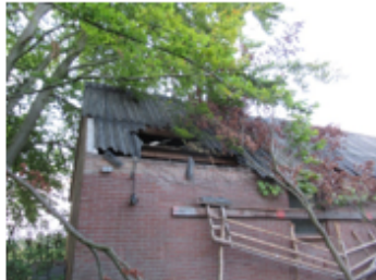
Figuur 1. Beschadigd asbest dak.
