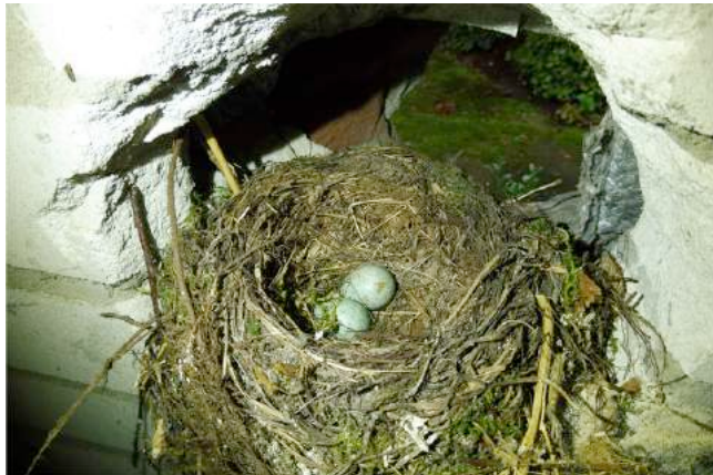
Verlaten merel nest in buitenwand van de varkensstallen
