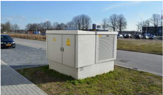
foto transformator voorziening materiaal: beton kleur: lichtgrijs
