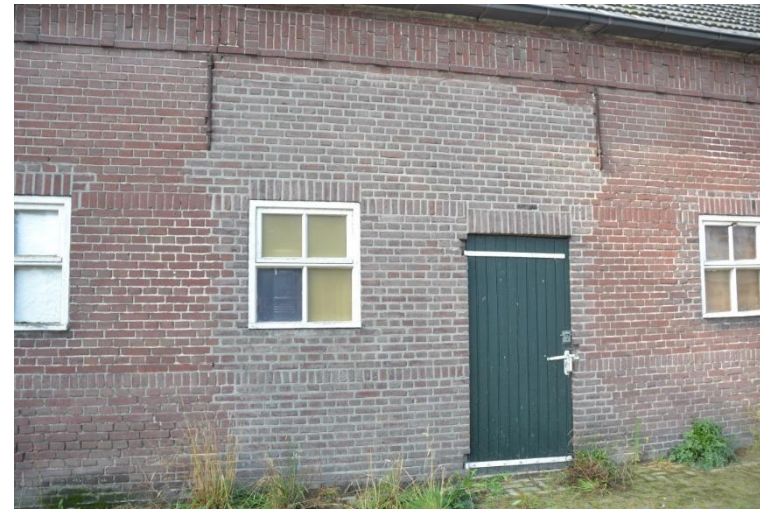
Stalvenster en loopdeur t.h.v. de voormalige deel. Ook bij de vensters links en rechts zijn bouwsporen zichtbaar.
