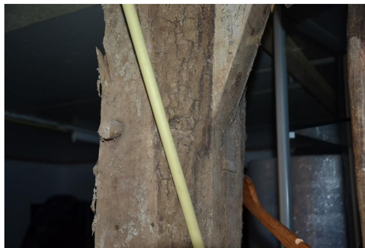
Voorste gebintstijl met intact korbeel en pen-en-gat verbinding.
