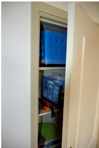
Afb. 23. Inbouwkast in de woonkamer.
