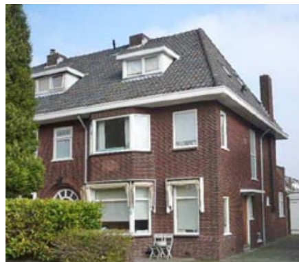
duidelijke bakgoot (overstek)
