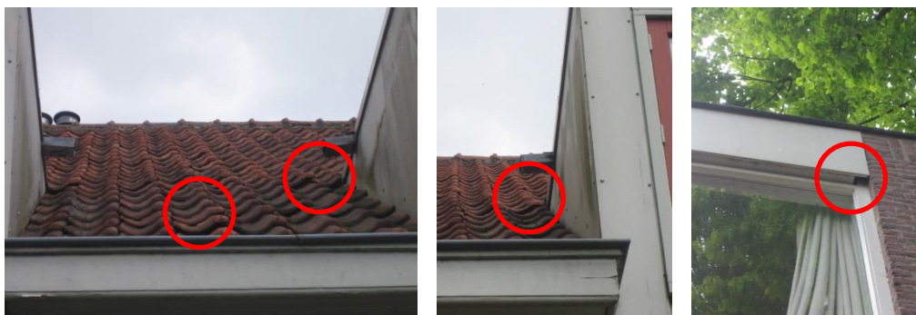
Afbeelding 3: kierende dakpannen op het dak van het voormalig wooncomplex (links en midden) en op de betimmering van de dakrand en het kozijn van het cultureel centrum (rechts) (SAB, 2013).
