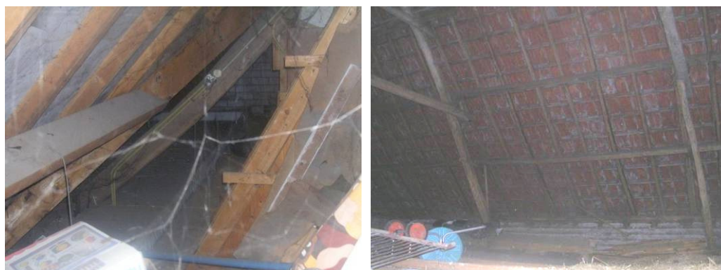
Isolatie materiaal en spinnenrag (links) en ongebruikte zolder (rechts)
