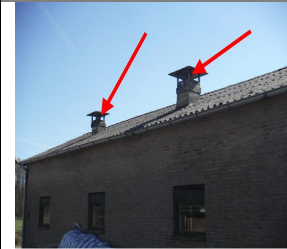
Foto 26 | Foto voor VM2 Vormstuk, ventilatieschacht
