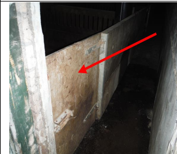
Foto 20 | Foto voor M10 Vlakke plaat, stalschot
