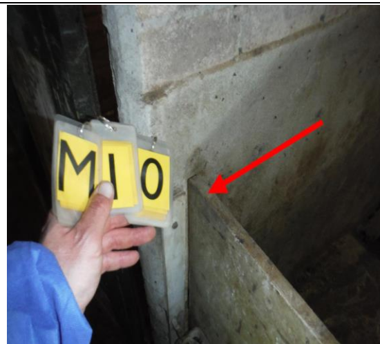
Foto 21 | Foto voor M10 Vlakke plaat, stalschot
