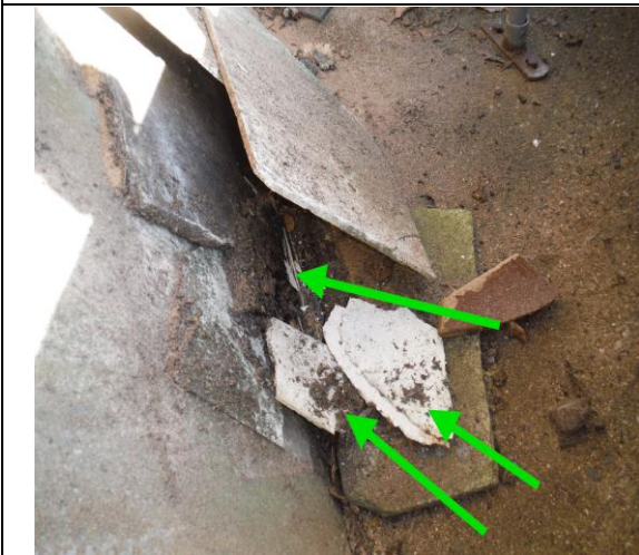
Foto 11 | Foto voor M6 Vlakke plaat, restanten
