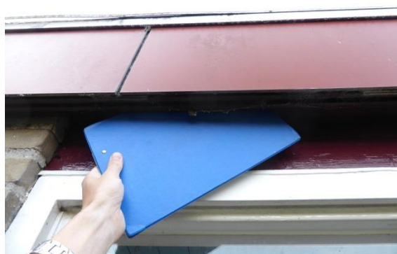
Holte achter dakrand.
