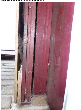
Holtes achter dakrand.
