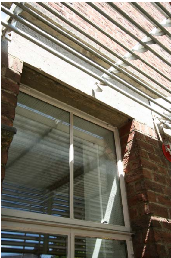
afb. 22: Detail voorgevel met betonlatei. Door de lamellen van de zonwering is de frijnslag op het beton zichtbaar.
