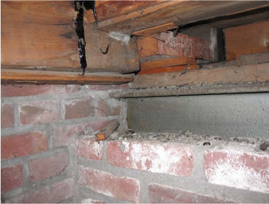
afb. 25: Aansluiting van de noordwestelijke hoek van de oude opslaghal net onder het dak. De muur van wit uitgeslagen baksteen is tegen de binnenspouwmuur en de stalen onderslag gemetseld maar heeft geen constructieve functie.
