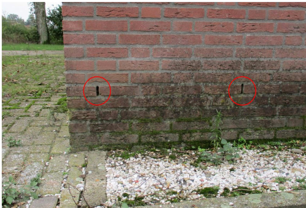
Figuur 4 Open stootvoegen in de garage staan te dicht bij de grond en is hierdoor ongeschikt voor vleermuizen.
