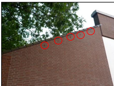
Figuur 23. Open stootvoegen in te slopen panden.
