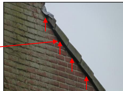
Figuur 22. Ruimte tussen buitenmuur en overhangende dakpannen..
