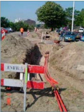
bomen moeten om de ruimte concurreren met kabels en leidingen
