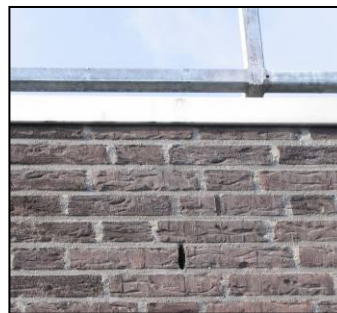
gaten in de buitenmuur
