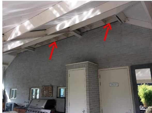
Fig.7 Onder kap van de veranda van het zwembadgebouw. Ingangen naar verblijfplekken in de dakconstructie.
