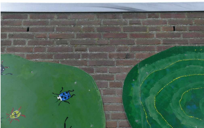
Foto 5: Spouwmuurgaten aanwezig aan een zijde van het schoolgebouw.
