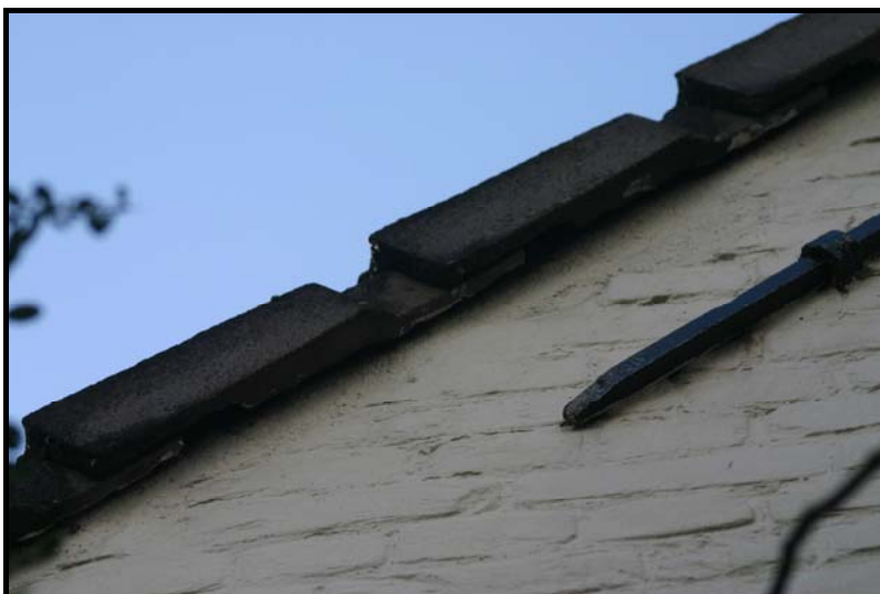
Figuur 3: Openingen tussen de hoekpannen en de muur aan de Aalstraatzijde van Heuvel 1.
