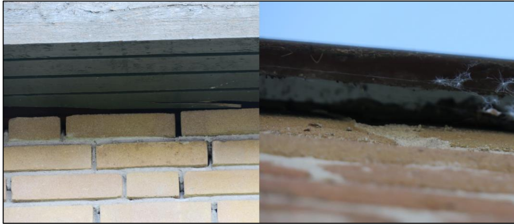
Figuur 4 Kierende daklijsten, open stootvoegen en kieren onder houten betimmering bieden toegang tot de open spouwruimte.
