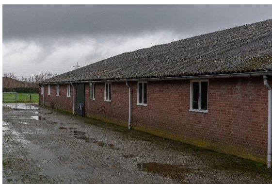
Noordelijke loods met asbest platen
