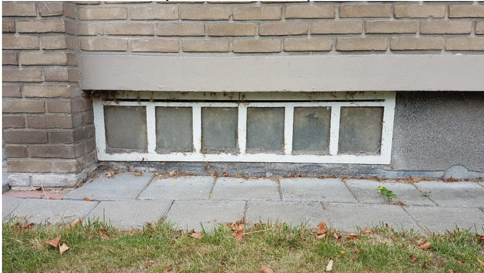
Foto 8. Voor vleermuizen geschikte kier boven raamkozijn naar kelder
